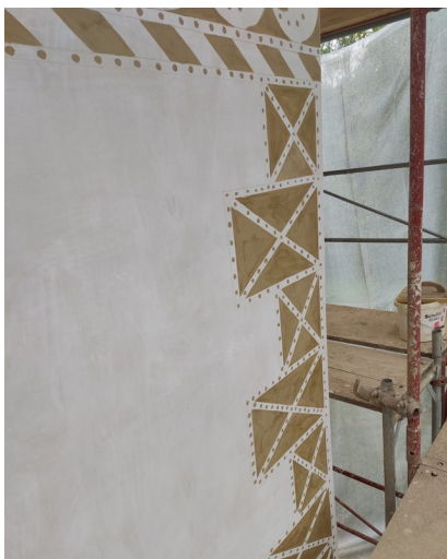
Noch feuchte Fläche
